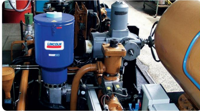
Pour les centrales hydroélectriques et les turbines fonctionnant 24/24h, une distribution fiable du lubrifiant est essentielle.
